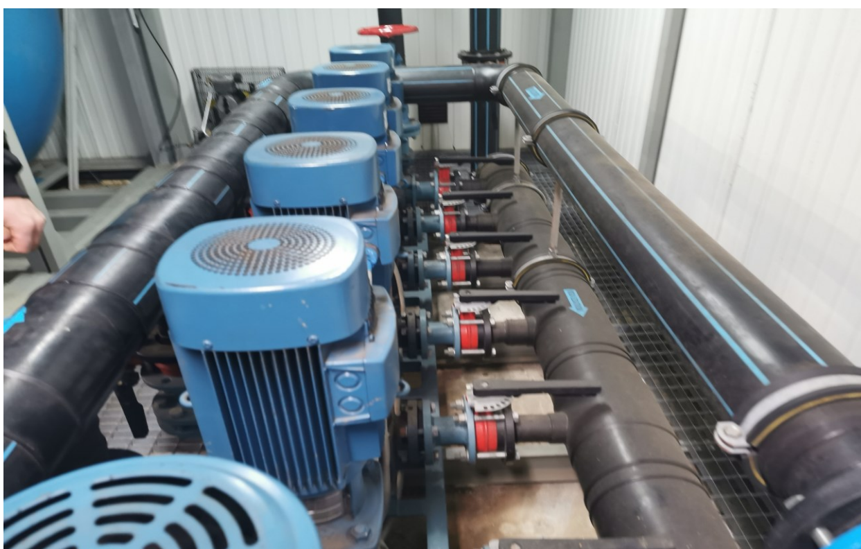
HALA KONTENEROWA SUW POMPOWNIA II 0 wody uzdatnionej
